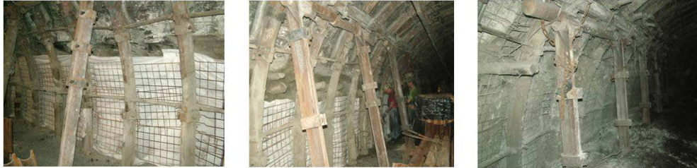
Rys. 8. Widok ociosu chodnika za ścianą po wypełnieniu kasztów i wykonaniu izolacji (fot. A. Ruchel)
