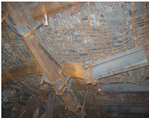
Rys. 7. Widok deformacji obudowy LPKO/V32/10/10 wzmocnionej stojakami stalowymi w rozstawie odrzwi obudowy co 0,75 m w rejonie wpływu krawędzi eksploatacyjnych
