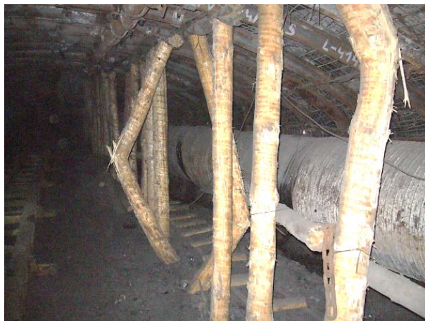
Rys. 4. Widok złamanych stojaków drewnianych w rozcince ścianowej rozruchowej w obudowie ŁPrP w rozstawie odrzwi obudowy co 0,75 m
