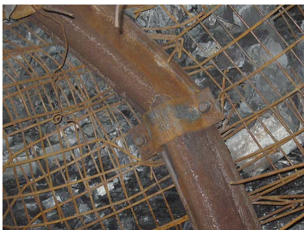
Rys. 8. Widok pękniętych odrzwi obudowy LPKO/V32/10/10 wzmocnionych stojakami stalowymi w rozstawie odrzwi obudowy co 0,75 m w rejonie wpływu krawędzi eksploatacyjnych
