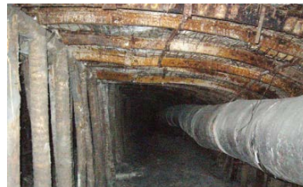
Rys. 11. Wzmocnione w miejscu przegięcia odrzwi obudowy ŁPrP (zdjęcie własne)
