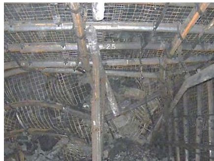
Rys. 13. Widok zawalu wyrobiska w obudowie ŁProB7/7,6/4 (Szostek 2016)
