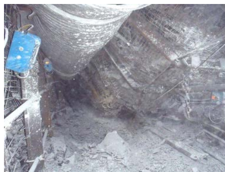
Rys. 15. Widok zawalu wyrobiska w obudowie ŁProj 6,4/3,6 (Szostek 2016)
