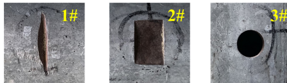
Fig. 12. The actual pipeline defects types.
