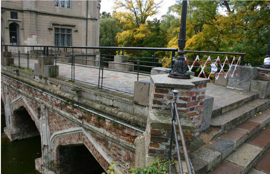
Most przed remontem. Fot. Z. Nowakowski
