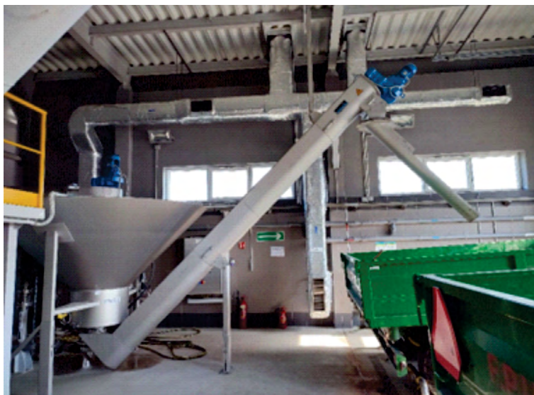
Fig. 1. Sand separator at the Kraków–Płaszów WWTP
