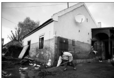
Fot. 1. Ślady zanieczyszczenia budynków i ziemi
